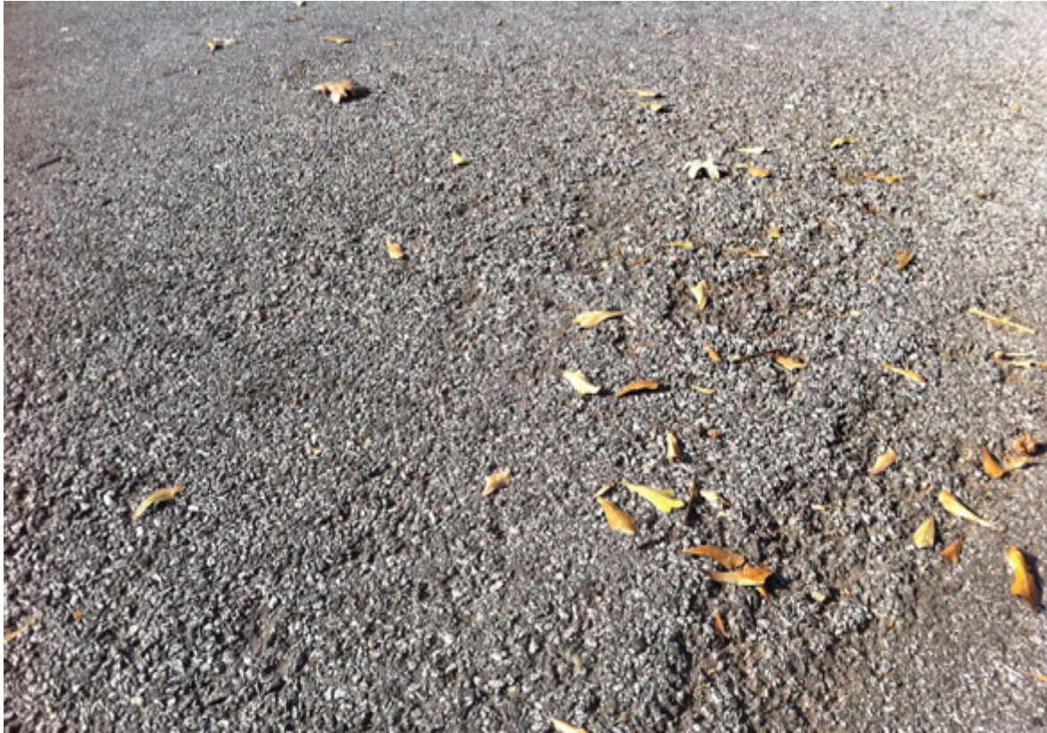
( ۳ ) Raveling (very porous asphalt)
